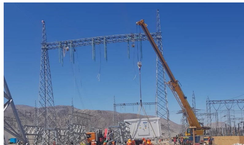
Subestación Los Changos-Kimal
